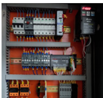
Instalación, Automatización y Control de procesos Industriales
