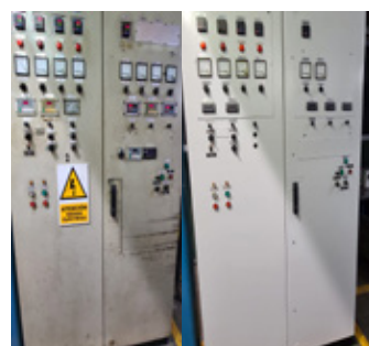
Mantenimiento (Preventivo - Correctivo)
