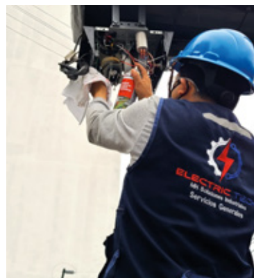
Mantenimiento Preventivo puerta levadiza eléctrica (Empresa YiChang)
