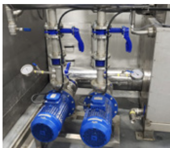
Bombas de Agua
